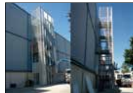
Sopraelevazione scala di emergenza in acciaio presso centro distribuzione dolciari "Perugina" 2013 Committente: Nestlé Italia S.p.a. - San Sisto, PERUGIA. Importo lavori: € 35.000,00
